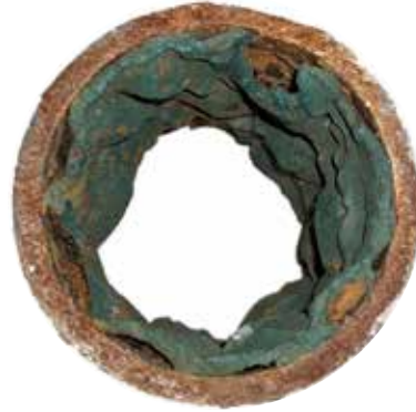
Das Innenleben einer 20 Jahre alten, mit Epoxidharz beschichteten Wasserleitung
